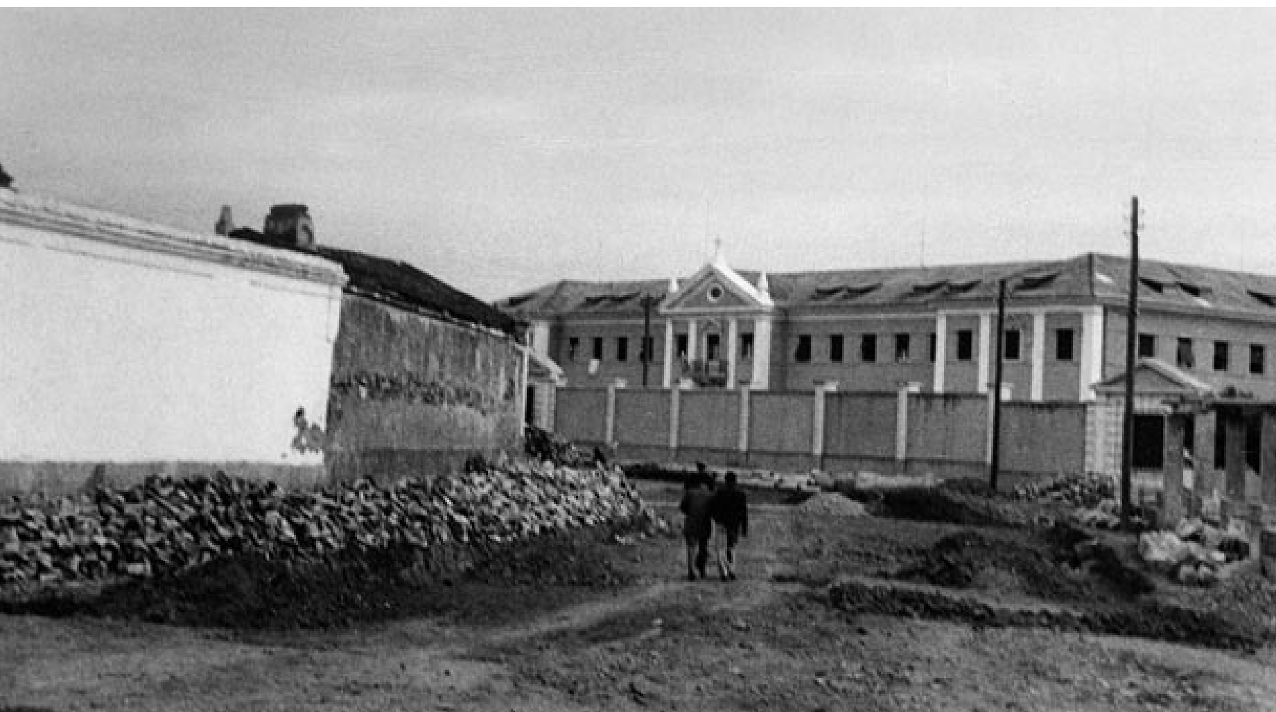
FIG. 74 Seminário Diocesano, cerca do jardim e espaço do actual parque de estacionamento do mercado, durante as obras de canalização. O mercado não havia ainda sido construído e o muro do jardim ainda viria a ser rebaixado. Am, B545.
